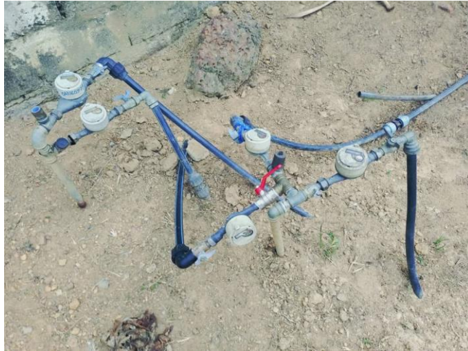
Image 1: photo des compteurs d'eau
