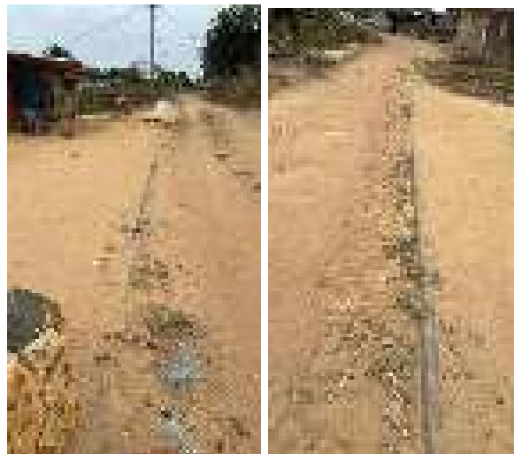
Photo 5: Conduite SEEG DN 80
